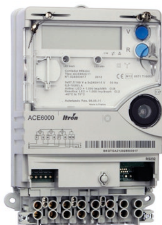
Aspecto del contador sin cubrehilos
